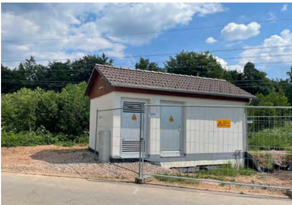
Neu errichtete 20-kV-Übergabestation des Verteilnetzbetreibers ED Netze
