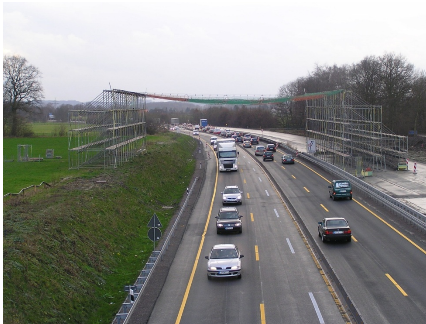
Abb. 51: Stahlrohrschutzkonstruktion mit Netz über einer Autobahn
