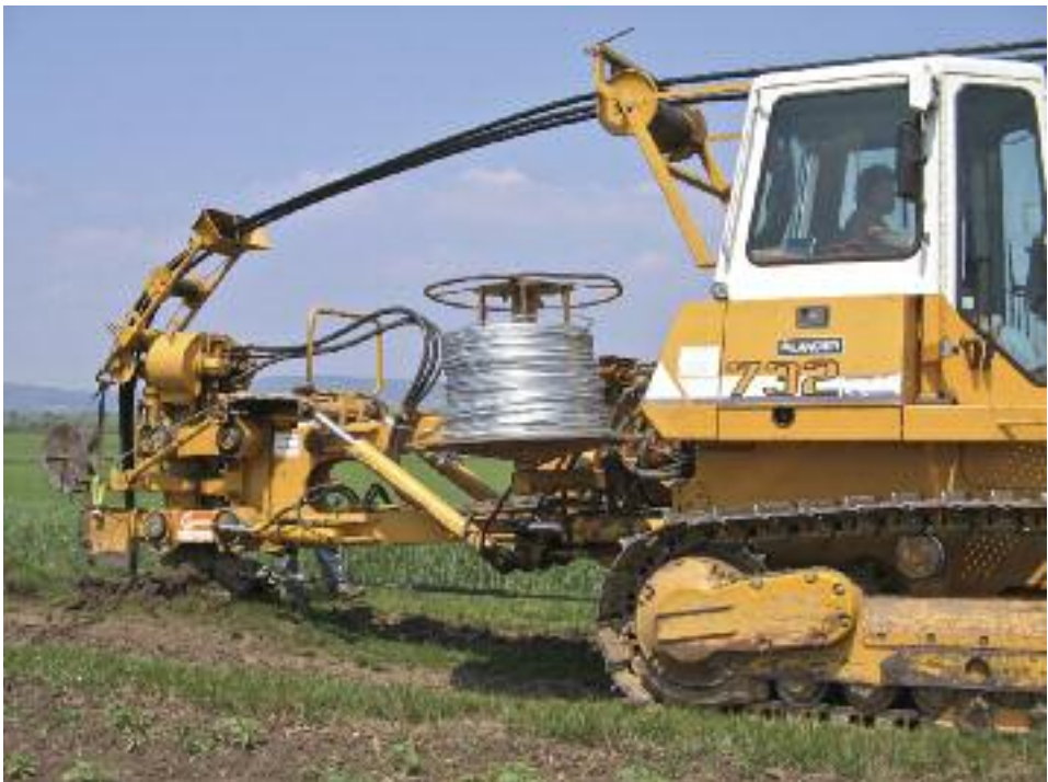
Abb. 5: Erdverkabelung einer Mittelspannungsleitung der EVN (mittlerweile Netz Niederösterreich GmbH) im Projekt – Teilgebiet Westliches Weinviertel (Foto: Sylvia Raab).
