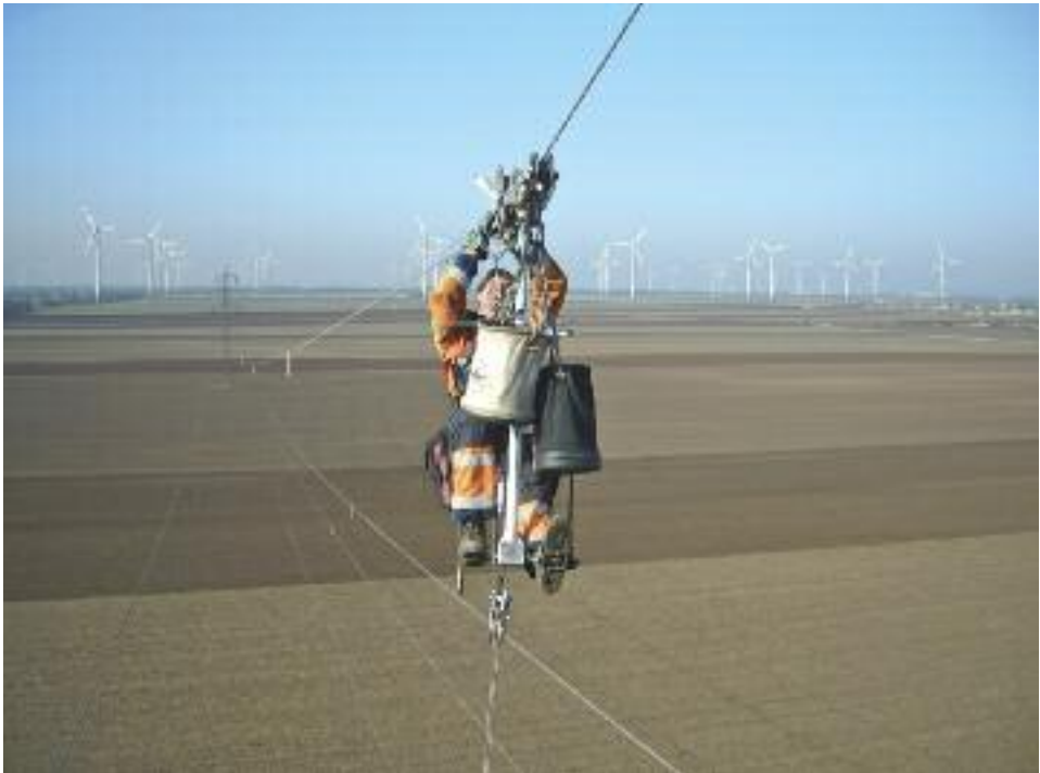
Abb. 7: Markierung einer Hochspannungsleitung der BEWAG (mittlerweile Netz Burgenland GmbH) mit Vogelwarnfahnen im Projekt – Teilgebiet Parndorfer Platte – Heideboden (Foto: BEWAG).
