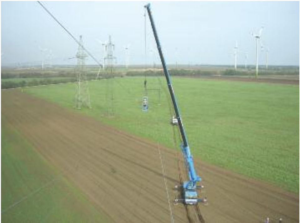
Abb. 8: Markierung einer Hochspannungsleitung der BEWAG (mittlerweile Netz Burgenland GmbH) mit Vogelwarnfahnen im Projekt – Teilgebiet Parndorfer Platte – Heideboden (Foto: BEWAG).
