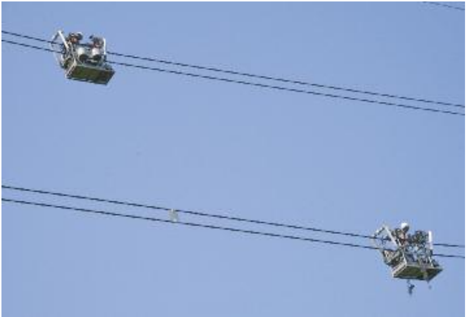
Abb. 9: Markierung einer Hochspannungsleitung der APG mit Vogelwarntafeln im Projekt – Teilgebiet Parndorfer Platte – Heideboden (Foto: Rainer Raab).
