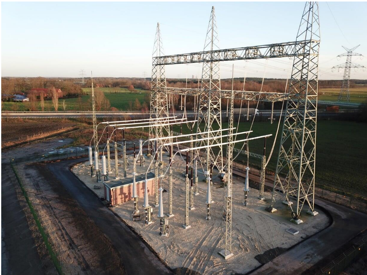
Abbildung 12: Kabelübergabestation Segberg an der A31 Erdkabel verlaufen unterirdisch von links in die Anlage. Auf der rechten Seite wird die Leitung als Freileitung fortgeführt.
