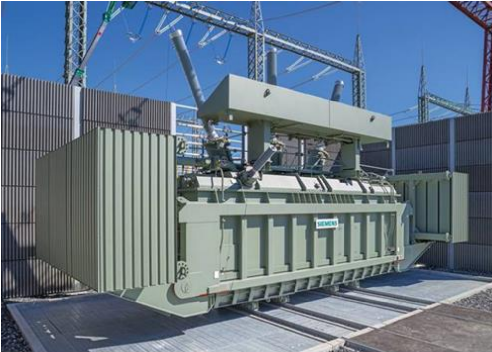
Abbildung 15: 250-MVAR-Drosselspule für die Blindleistungskompensation (Quelle: Siemens)
